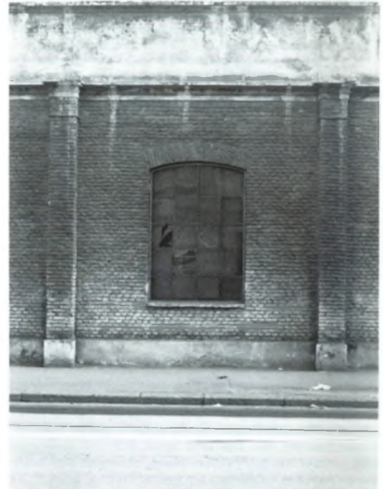
101. Modulo (con finestra) della manica vecchia della Fornara lungo via Genova. Stato attuale.
