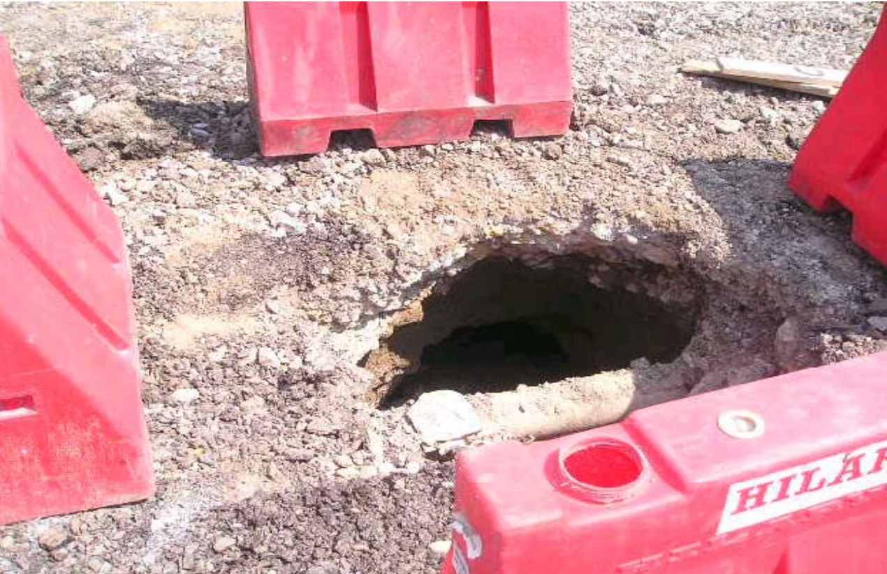
Foto 143-144 : voragine nella parte centrale di piazza Rivoli
