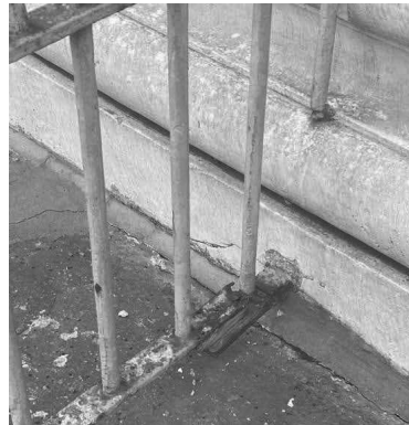
Dettaglio del degrado delle parti di ferramenta
